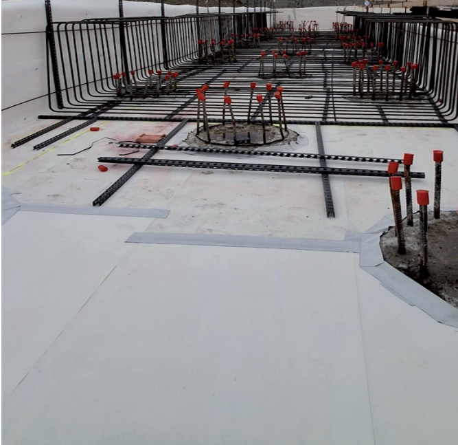
Anwendung der ECOTIGHT PLUS Folie bei einer Folgeetappe mit Anschluss an Bohrpfahl (rechts). Die Stösse wurden mit ECOTIGHT PLUS Inside Tape verklebt.
