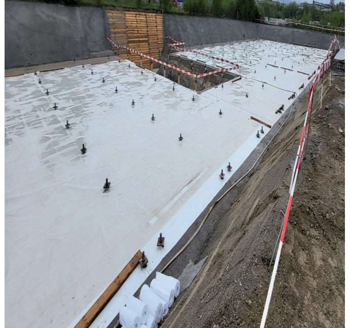
Vollflächige Abdichtung mit der ECOTIGHT PLUS Folie bei einer Bodenplatte mit Erdanker-Anschlüssen.
