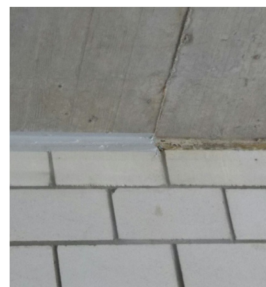
Joint EI90 avec Intumex® AS par revêtement de la laine de roche déjà existante
